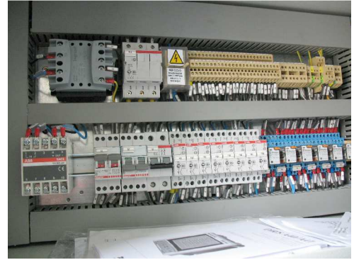
Interno cassonetto di quadro M.T.
