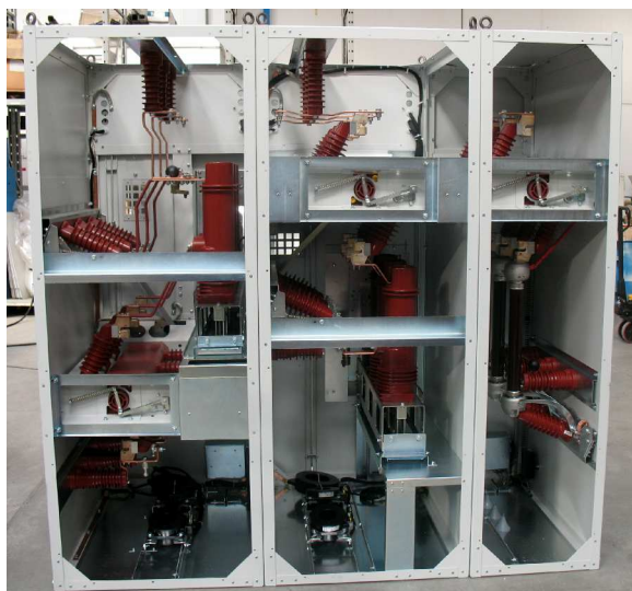
Interno quadro M.T.
